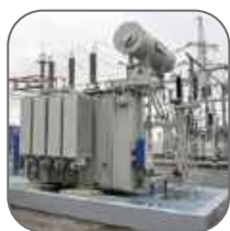
Объекты энергетической отрасли
