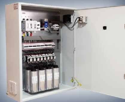
Установки компенсации реактивной мощности
